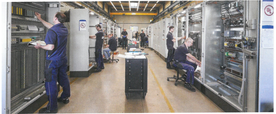
Schaltschrankkompetenz für internationale Märkte – ATR fertigt in Krefeld rund 6.500 Meter Schaltschränke
